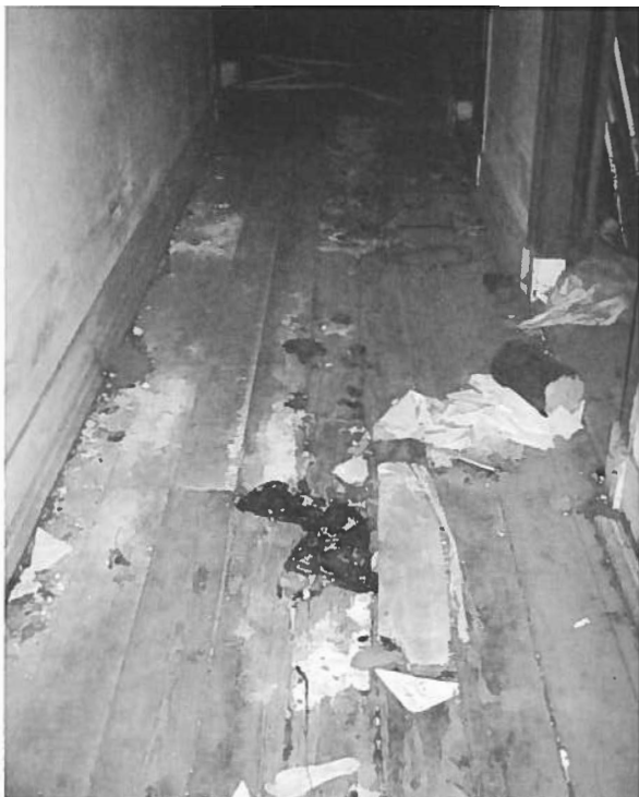
Fig. 18 Degradação do pavimento causada fundamentalmente por acção directa do homem – vandalismo. Fonte: Arquivo pessoal Luís Corredoura.
