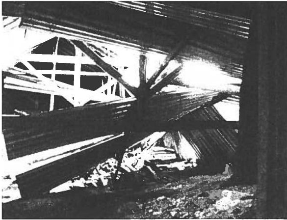
Fig. 26 Zona da estrutura da cobertura que colapsou há cerca de três anos. As chapas de zinco teriam sido colocadas não muito antes do colapso da estrutura por forma a evitarem infiltrações maiores. Fonte: Arquivo pessoal Luis Corredoura.
