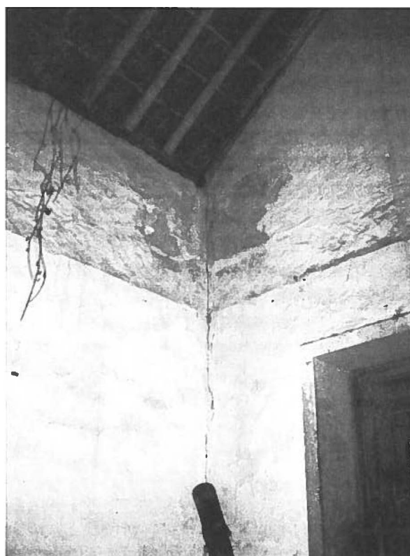
Fig. 21 e 22 Fendilhação provocada pela acção da água no interior das paredes. Fonte: Arquivo pessoal Luis Corredoura.
