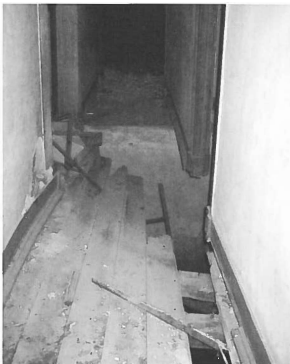
Fig. 19 Colapso da estrutura que sustinha o pavimento. Fonte: Arquivo pessoal Luís Corredoura.
