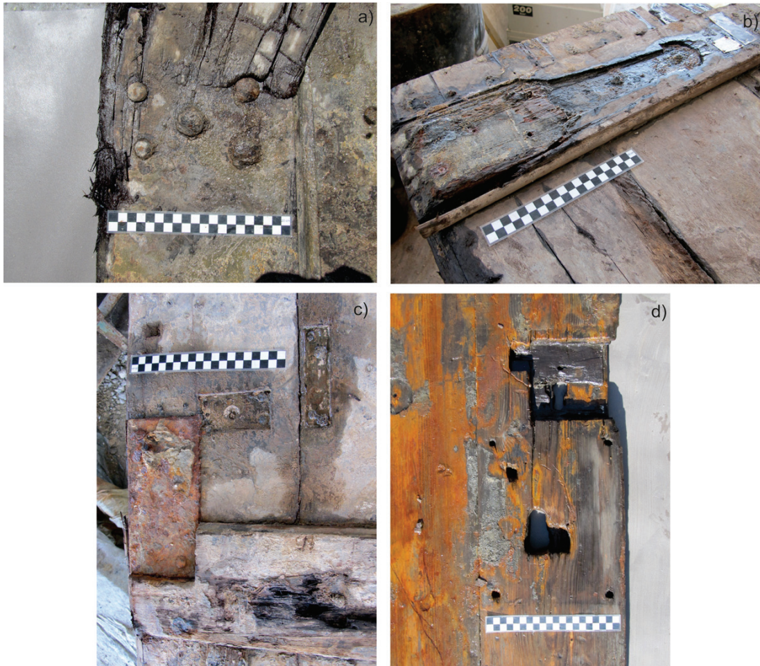
Figura 6 – a) Tachas de maiores dimensões da porta 10298; b) Travessa à cola da porta 10298 de aresta boleada e entalhe para receber o leme da dobradiça; c) Pormenor da porta 10298, com fechadura de ferro embutida e entalhes de possíveis pegas ou puxadores; d) Pormenor dos entalhes e orifícios associados aos dois sistemas de fecho da porta 13084D6; escalas 20 cm.
